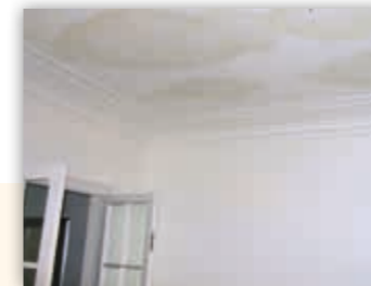
Vochtplekken op muren of plafonds? Boonstoppel Garantietex Isoleer lost het op.
